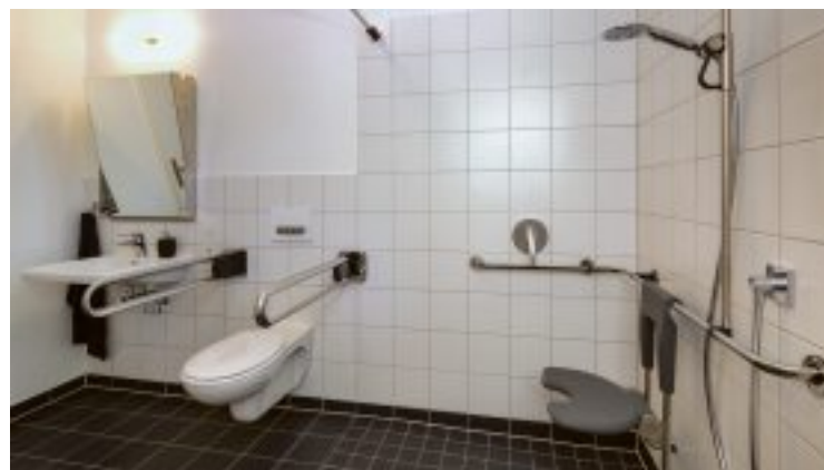
Eine Dusche ohne Schwelle sowie Griffe und Handläufe sind wichtig für ein barrierefreies Wohnen.
